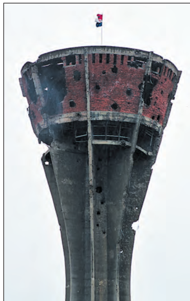
Напівзруйнована водонапірна башта, пошкоджена сербськими військами в 1991 р. Вуковар (Хорватія)
