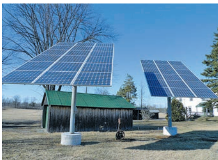
Рис. 9. Напівпровідникові сонячні панелі, встановлені на приватній ділянці
